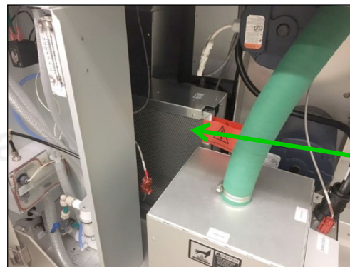
Tấm lọc khí quạt thổi ballast Xe-3
